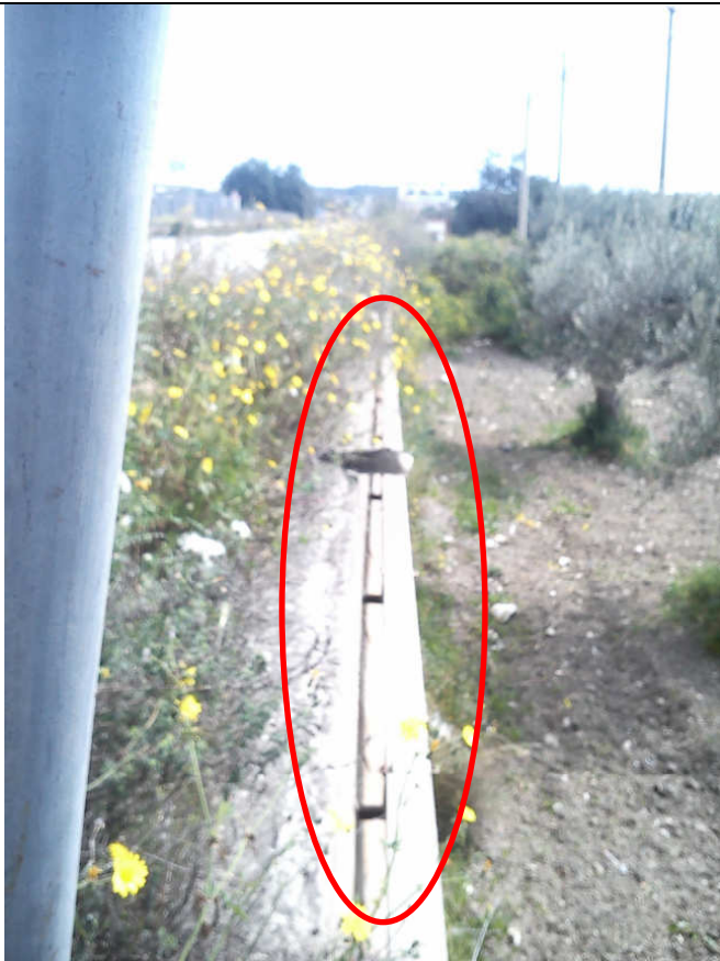
Linea Telecom in rame staffata in canaletta in corrispondenza di tombino esistente, che lungo tutto il tracciato è interrata.
